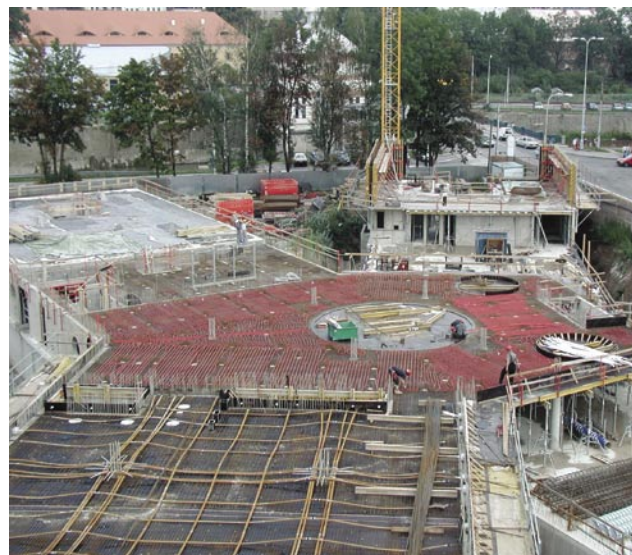
Systém BKT - celkový pohled
