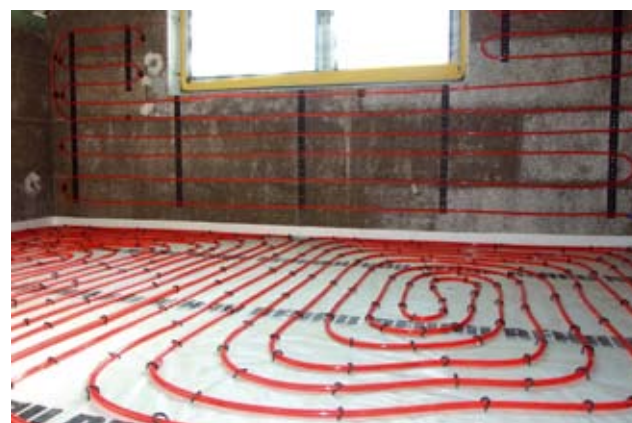
Hospodárne riešenie - kombinácia stenového a podlahového chladenia a vykurovania
