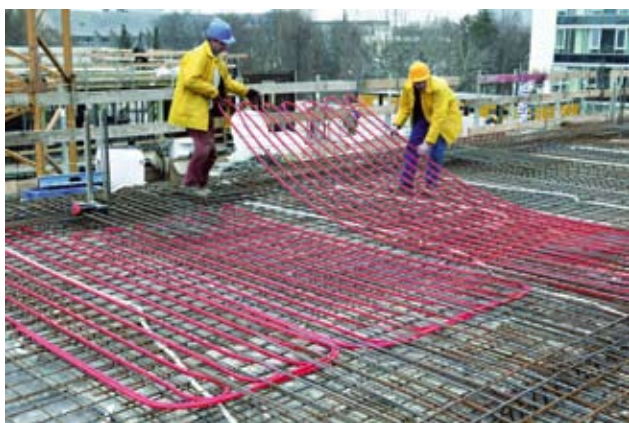
Hospodárne riešenie - stropné chladenie zabudované do monolitického betónového stropu
