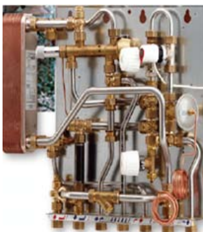
Príklad použitia ventilu PT°C vo výmenníkovej stanici:
