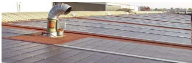
Obr. 3: Strecha s FV systémom Tegola Solar
