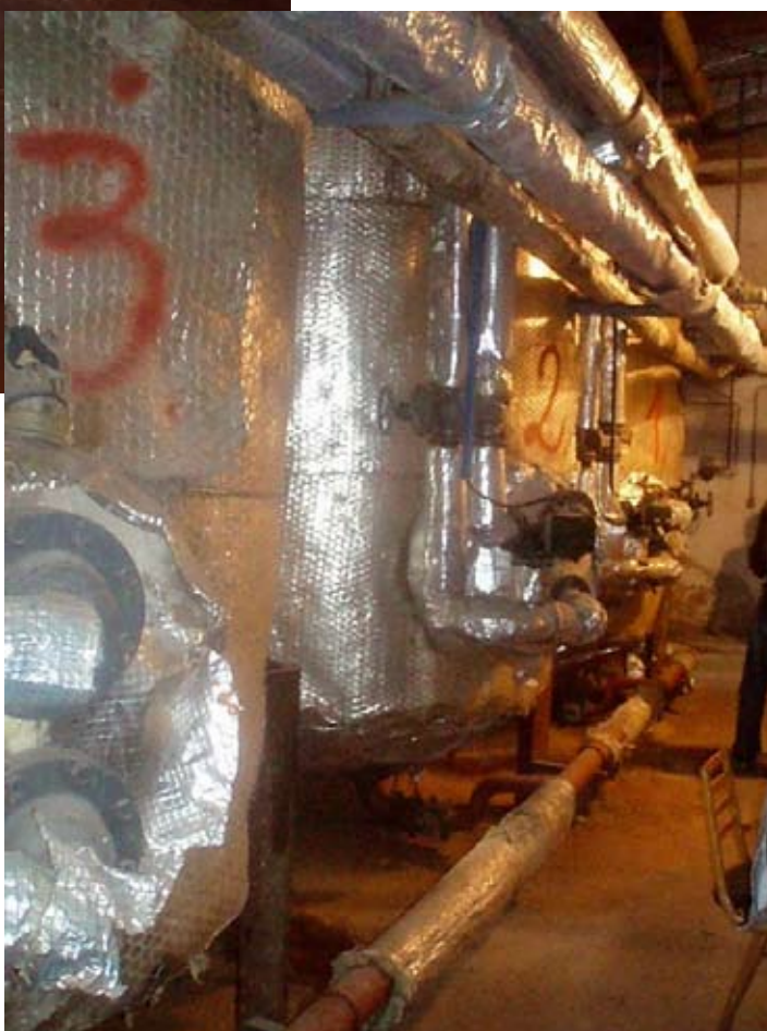
Obr.č.3: Kotolňa P2 – pohľad na zásobníky
