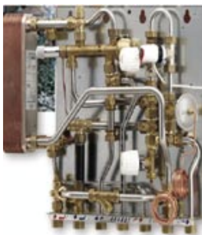
Príklad použitia ventilu PT°C vo výmennikovej stanici:
