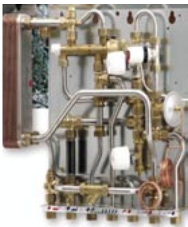
Príklad použitia ventilu PM je vo výmennikovej stanici:
