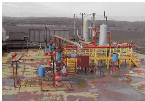
Obr. 2: Technologické zariadenie na vrtoch v Ďurkove. Zdroj: Geoterm-Košice.
