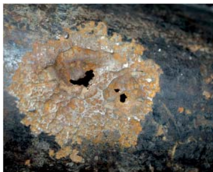
Obr.2: Korózne poškodenie plynového oceleového potrubia [2]
