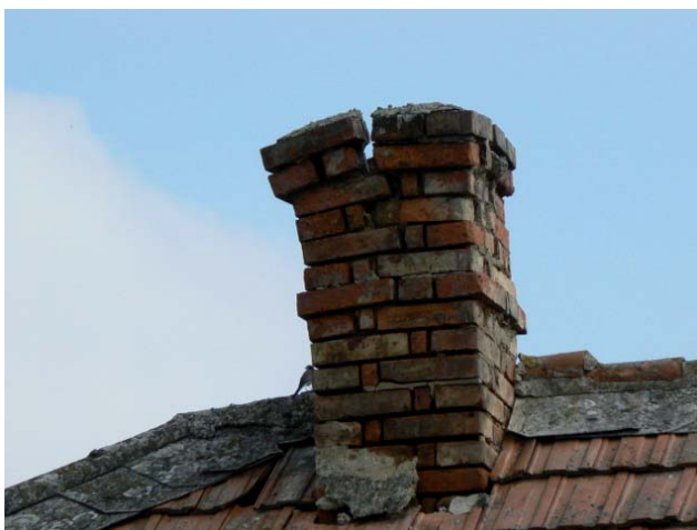
Obr.3: Deštrukcia komínového telesa
