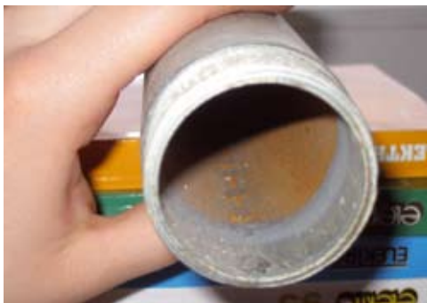
Obr. 1: Oceľové potrubie pozinkované len 5 cm od okraja rúry[12]
