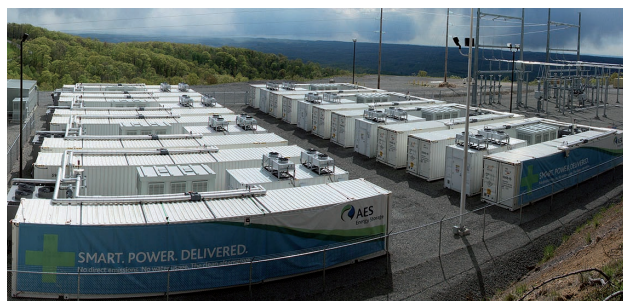
Obr.1: AES – Veľkokapacitná inštalácia, Laurel Mountain, 64MW [1].
